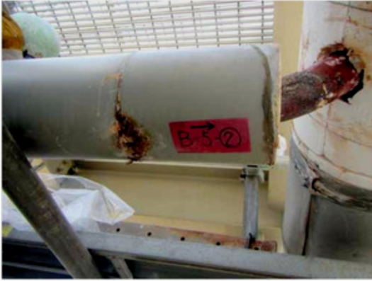
蒸気漏れがあった、玄海原発三号機の配管。配管を囲う金属の外装板にも、さびが見える(中央付近、九州電力提供)(4月3日 朝日新聞)
